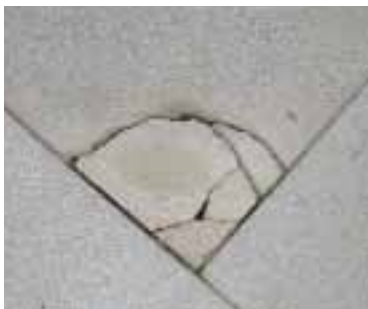
Руйнування вапняку (плити мощення)
