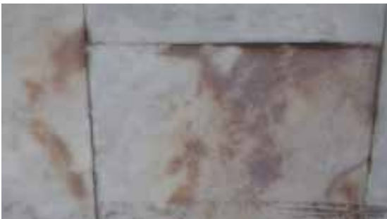
Виділення іржі на поверхні плити з мармуру
