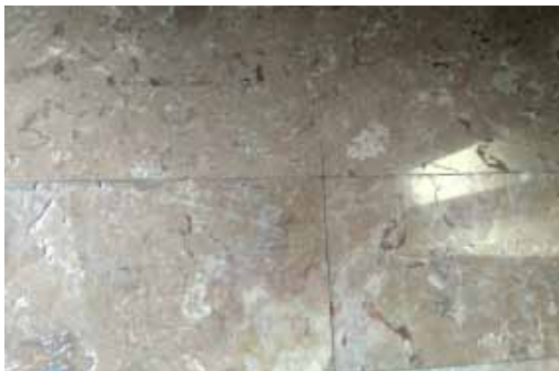
Дезінтеграція і руйнування поверхні облицювання з мармуру
