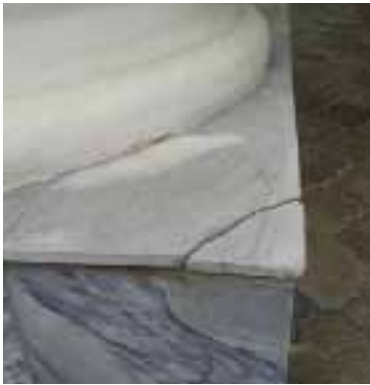
Тріщина на плиті з мармуру (базис колони)
