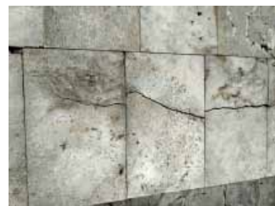
Тріщини на плитах з травертину (облицювання будівлі)
