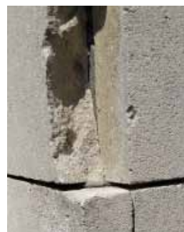
Вилущення вапняку (облицювальні плити)
