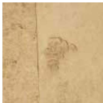
Вилущення вапняку (облицювальні плити)
